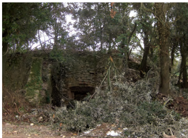
Forn gran de Fonteta afectat per la nevada.
